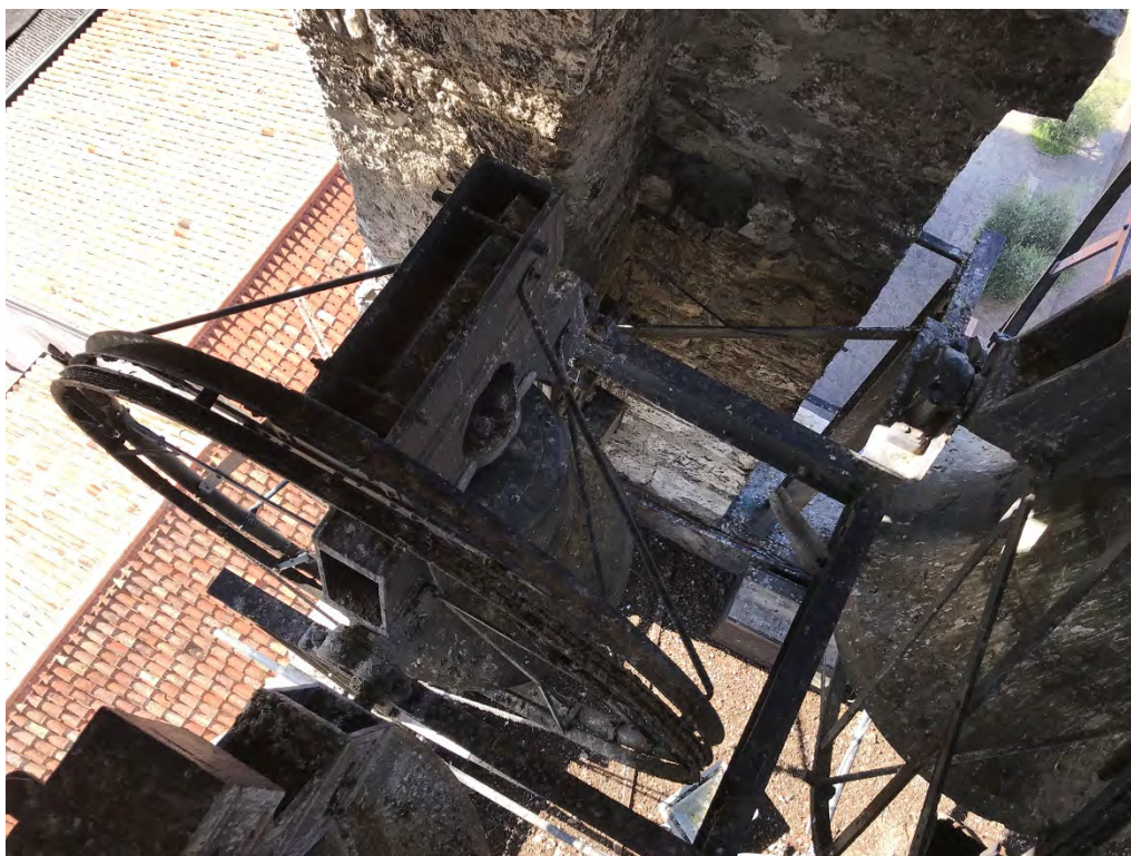
Lo stato della campane e del castello campanario, ricoperte dal guano dei piccioni
