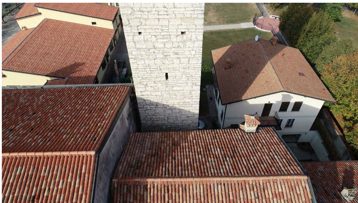
Foto 20 – Fronte est (presbiterio): rappezzi cementizi
