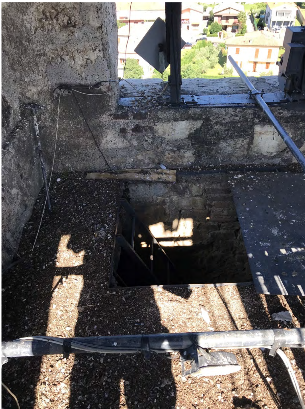
Estradosso dell'orizzontamento del piano campane, completamente insozzato dai piccioni
