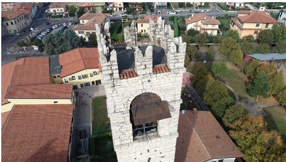
Foto 17 – Fronte sud: rappezzi cementizi e distacchi nella parte alta della facciata
